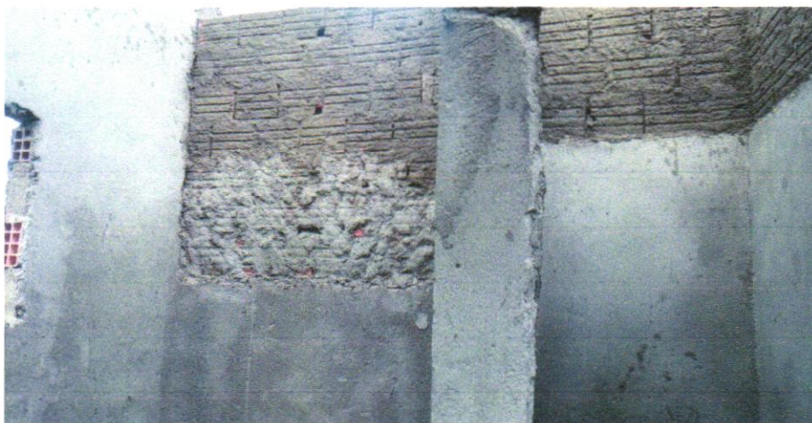
FOTO 02 - CHAPISCO APLICADO EM ALVENARIAS E ESTRUTURAS DE CONCRETO INTERNAS, COM COLHER DE PEDREIRO. ARGAMASSA TRAÇO 1:3 COM PREPARO EM BETONEIRA 400L.
