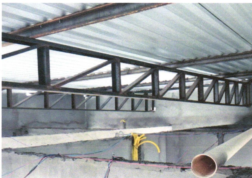
Foto 10 - FABRICAÇÃO E INSTALAÇÃO DE TESOURA INTEIRA EM AÇO, VÃO DE 10 M, PARA TELHA ONDULADA DE FIBROCIMENTO, METÁLICA, PLÁSTICA OU TERMOACÚSTICA, INCLUSO IÇAMENTO. AF_12/2016
